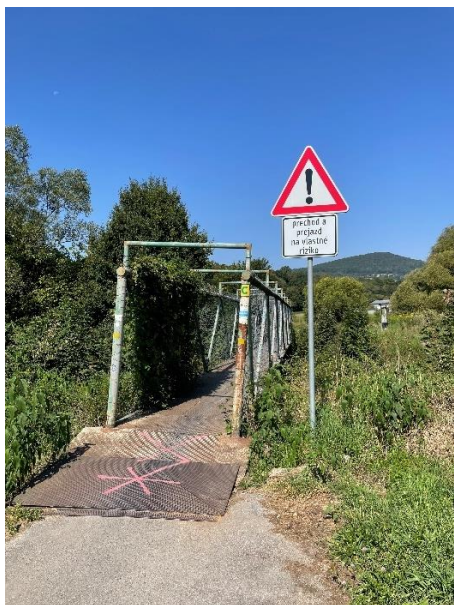
Súčasná nevyhovujúca lávka
