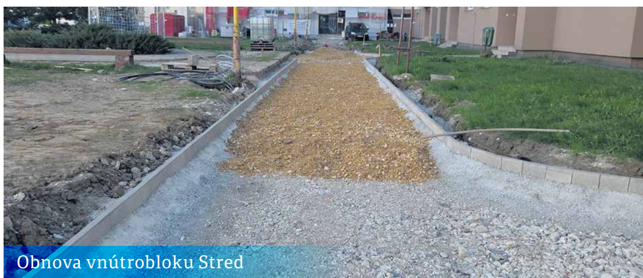
IBV Pod Horou, mestská časť Klúčové
