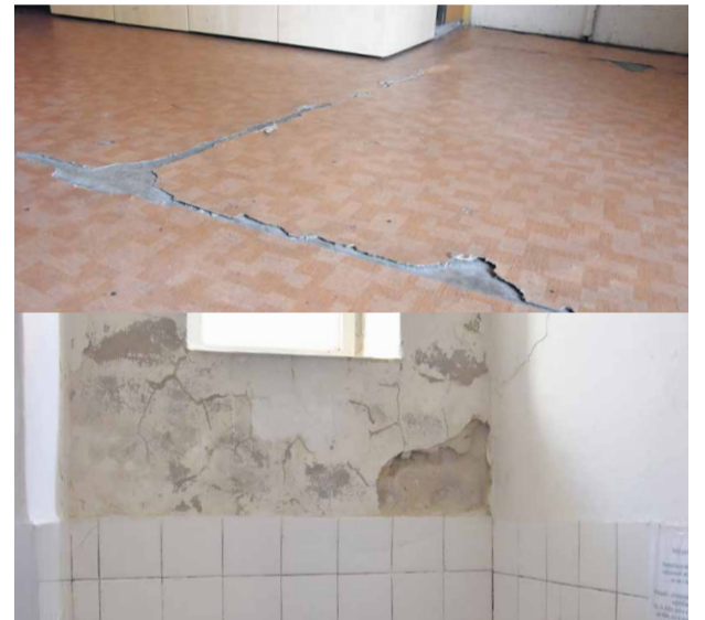
Aktuálny stav – ometka a podlahy sa rozpadávajú
